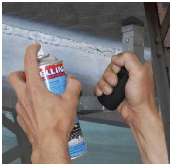
Проверка сварных соединений моста с помощью черной суспензии BW 333 и белой фоновой краски NR 104 A
